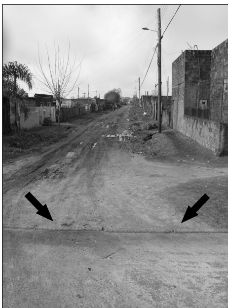
Figura 11 – Detalhe do desnível entre as ruas S e E
