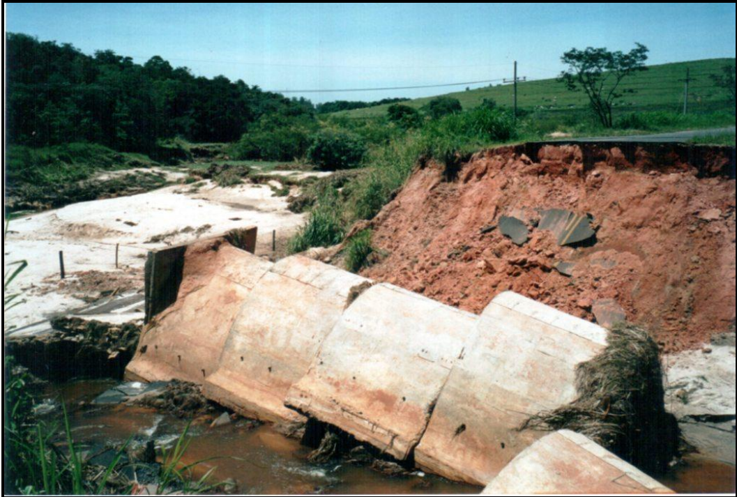
Foto 3: Por pressão hidráulica, os dutos se desalinham e a estrada vicinal que serviu como uma verdadeira barragem rompeu-se, fazendo a lente hídrica volumosa se destinar para jusante do rio. Areias e argilas foram deslocadas em grande quantidade e depositaram-se nos pontos onde a corrente de água perdeu a capacidade de transporte. (Foto do autor, fev/2005).
