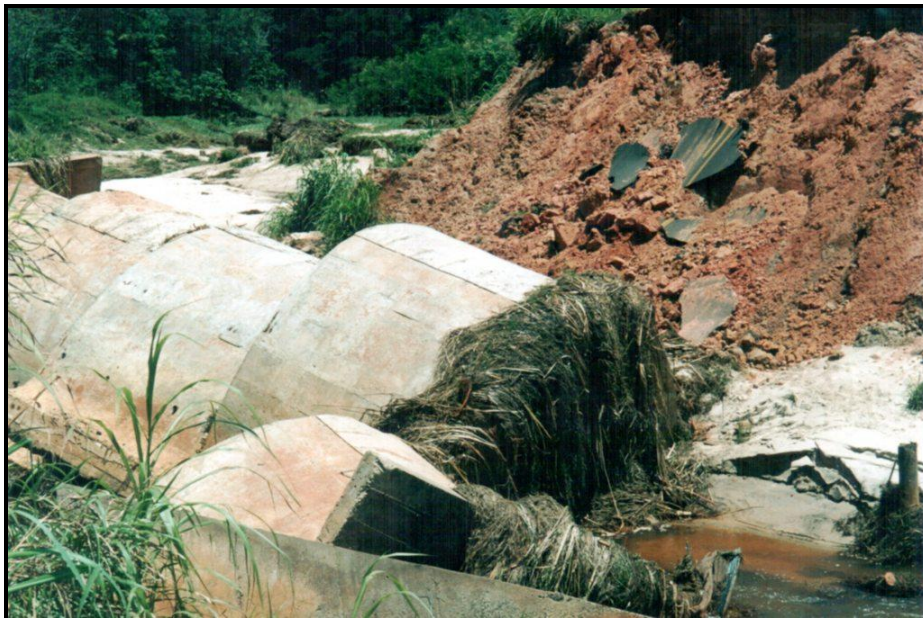
Foto 2: De forma impressionante, as linhas de tubos condutores de água fluvial foram entupidas por grande massa de taboas , arrancadas pela água precipitada que transbordou do canal do rio para as várzeas, impedindo o fluxo normal da corrente hídrica e represando a água de montante. (Foto do autor, fev/2005).
