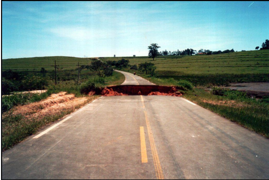
Foto 4: No ponto onde os dutos estavam alinhados, a terraplanagem cedeu e formou um enorme buraco na pista de rodagem, impedindo o tráfego dos veículos. Os prejuízos foram de monta e na ocasião provocou a morte de duas pessoas que conduziam um veículo que se destinava à cidade de Corumbataí. (Foto do autor, fev/2005).
