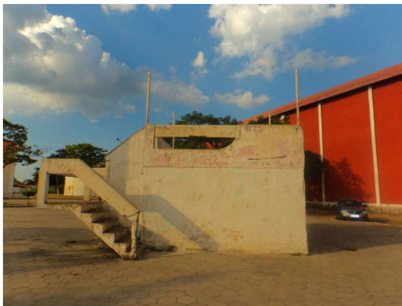
Figura 5 – Palco da Adalton Gomes (Bairro de Santa Cruz) Autora: Aline Guimarães de Souza Sant’Anna (2016)
