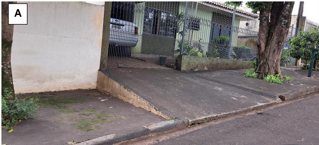
Figura 9 - Descontinuidade da calçada na Ruas das Mangueiras (Vila Vardelina)
