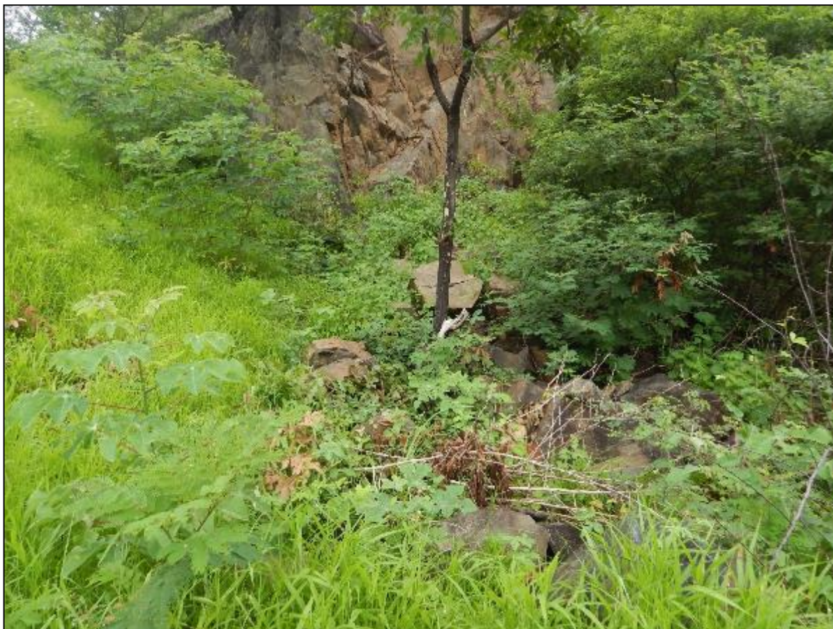
Figura 11. Matações que se destacaram do talude.
