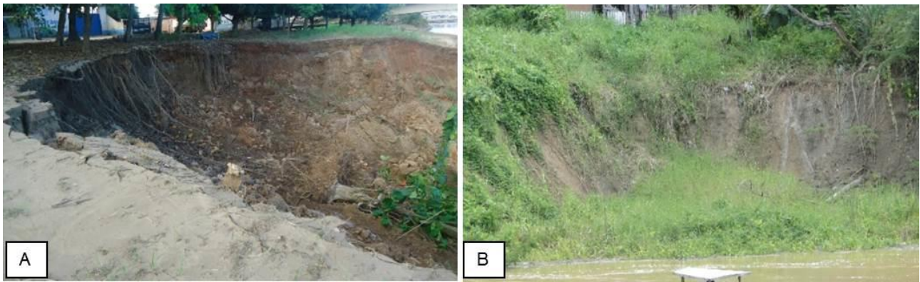
Figura 7 - Eventos ocorridos em fevereiro de 2015, logo após o rebaixamento do nível das águas no rio Acre: A) unidade QVA2; B) unidade SVM3.
