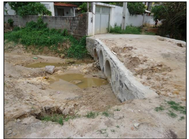
Figura 5. Ocupação urbana indevida, erosão e assoreamento interferindo no fluxo do curso Foto: Fraga, 2013.
