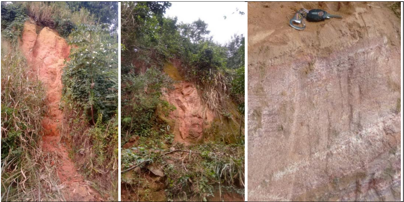
Figuras 5 – A e B) Aspecto geral dos perfis de solos da Vigilância Sanitária e da Rua Ligação, respectivamente. C) Horizonte C residual (solo saprolítico), com minerais secundários esbranquiçados e vestígios de estruturas reliquias.
