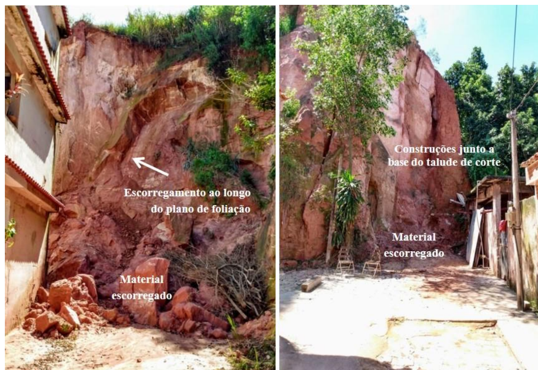
Figuras 3 - Construções próximas da base do talude da Rua da Ligação com observação de escorregamento ao longo do plano de foliação.
