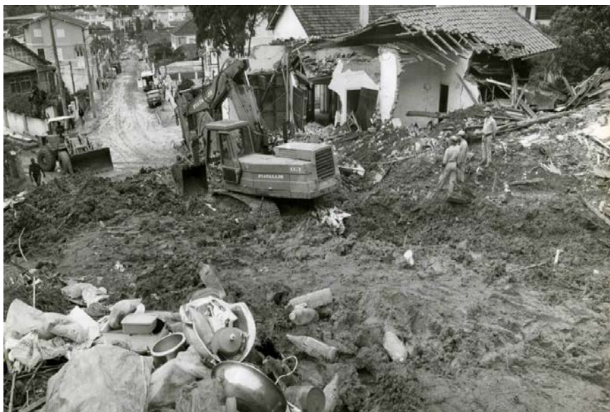
Figura 4 - Deslizamento ocorrido da Rua Casimiro de Abreu durante as intensas chuvas de fevereiro de 1988; apenas nesse local nove casas foram destruídas e 40 pessoas foram soterradas (Fonte: Hipólito Pereira, 10/02/1988, Agência O Globo).
