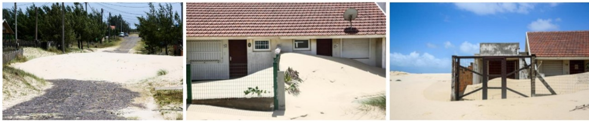
Figura 6 - Avanços das dunas sobre as residências (Fonte: Marco Favero/GZH-Agência RBS, 2020)
