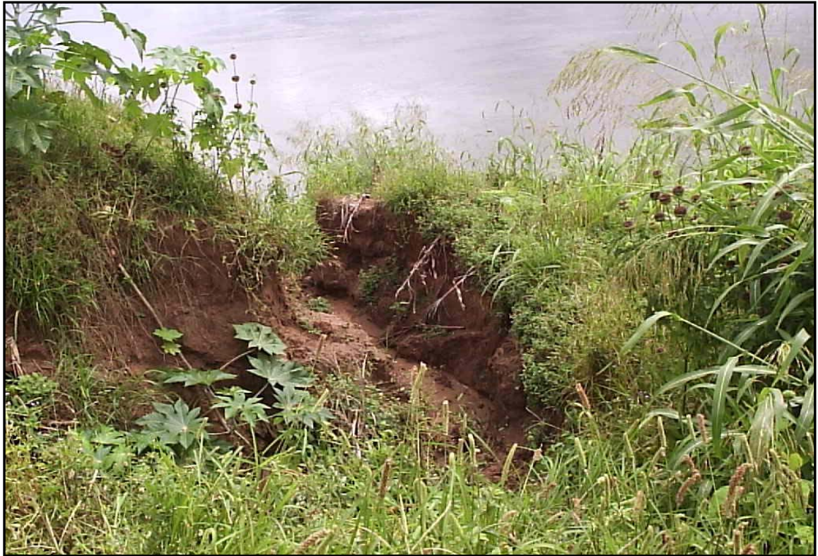
Figura 4 – Processo erosivo no barranco da margem esquerda no rio Tocantins (município de Miracema), os ribeirinhos afirmam que tem ocorrido este fato em função da oscilação brusca do nível do rio, decorrente da necessidade de volume de água para geração de energia. Foto: Kelson Dias Gomes, abril/2006
