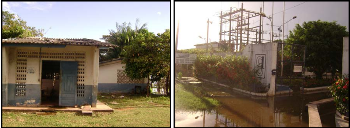
Figuras 10 e 11: Captação de água e usina termoeletrica em área de alto risco. Fotografia: Orleno Marques, 2010.
