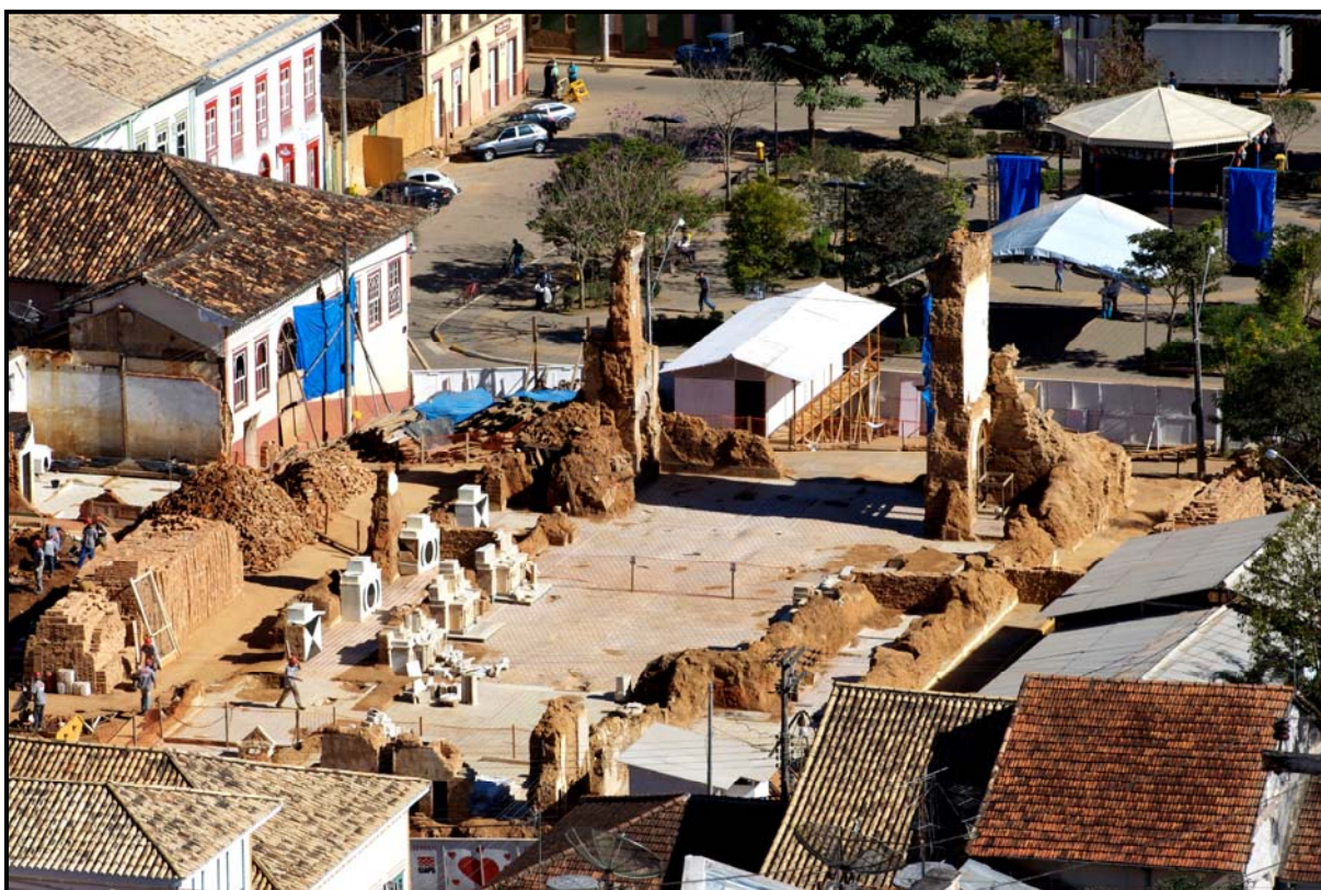
Figura 4 – Remanescentes da Igreja Matriz de São Luís de Tolosa após obras de salvamento executadas pelo IPHAN.
